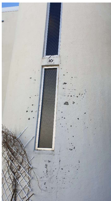
Skader i pussen
