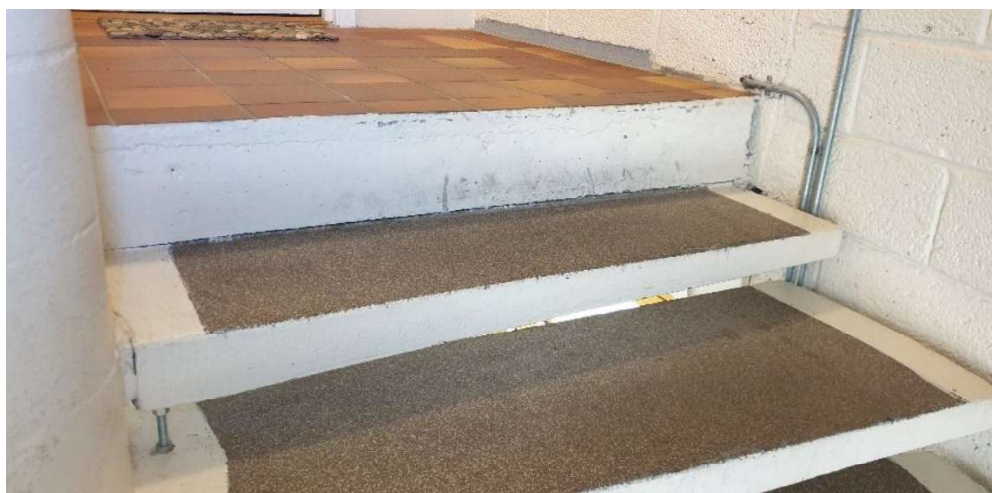
Trinn innfestet under repos og sikret med støtte mot underliggende trinn
