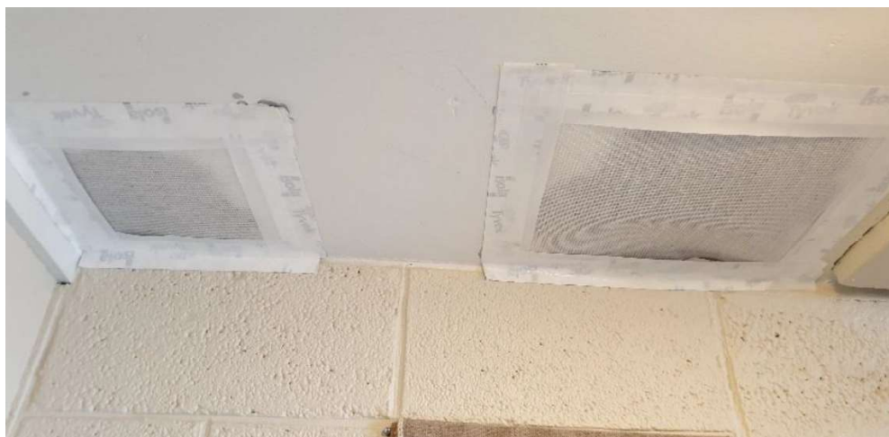
Avskalling av betong på undersiden av repos sikret mot nedfall
