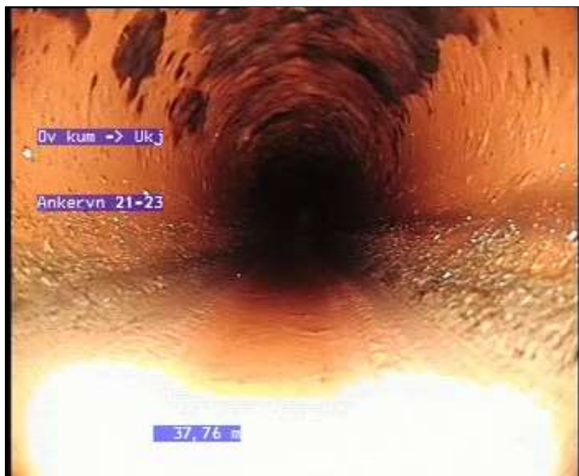
Foto: 4_1_12_11112014_045310_A.jpg 37,7m, Utfelling/Belegg, reduksjon i tverrsnittsarealet er 5% eller mindre, fra 12 til 12 Kl., Biofilm, Start
