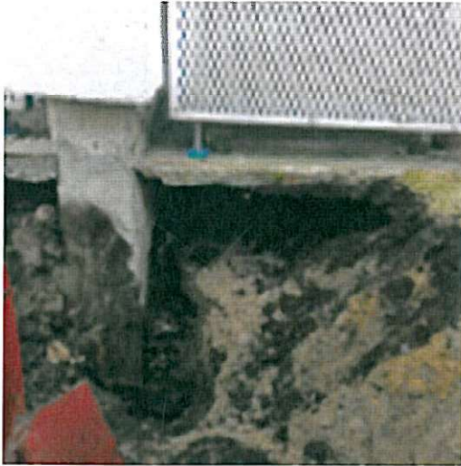
Bilde 1: Kollapset betongdekke
