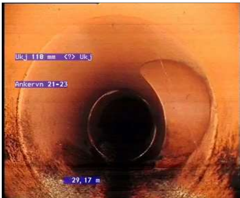
Foto: 5_1_12_11112014_054036_A.jpg 29,1m, Tilkopling Prefabrikkert grennrør, fra 01 til 05 Kl.
