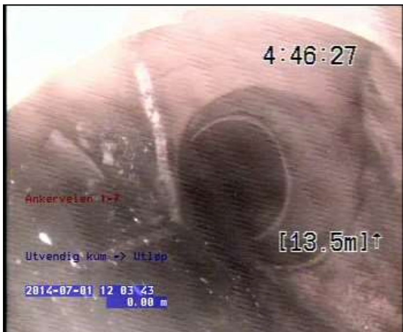
Foto: 3_1_4_10112014_052900_A.jpg 13,5m, Tilkopling Prefabrikkert grennrør. fra 07 til 11 Kl.
