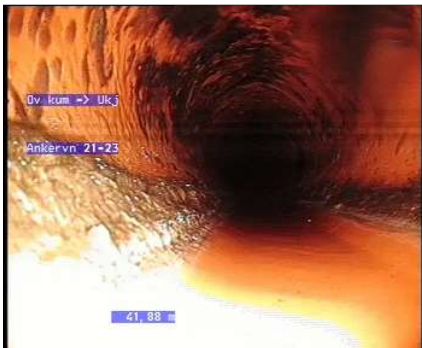
Foto: 4_1_16_11112014_045343_A.jpg 41,8m, Utfelling/Belegg, reduksjon i tverrsnittsarealet er 5% eller mindre, fra 05 til 07 Kl., Fett, Start
