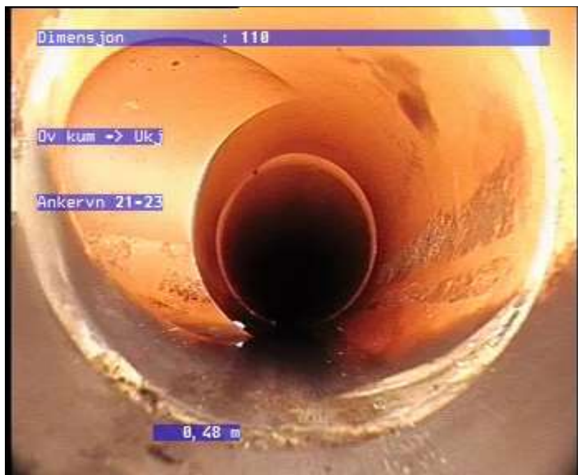
Foto: 4_1_2_11112014_043559_A.jpg 0,4m, Tilkopling Prefabrikkert grennrør. fra 06 til 12 Kl.
