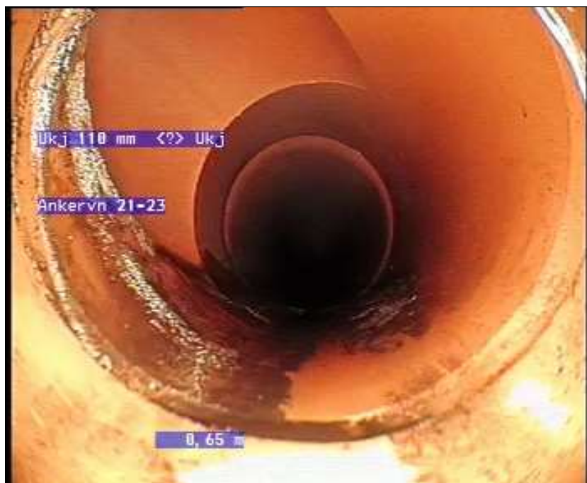
Foto: 5_1_2_11112014_050218_A.jpg 0,6m, Tilkopling Prefabrikkert grennrør. fra 07 til 01 Kl.
